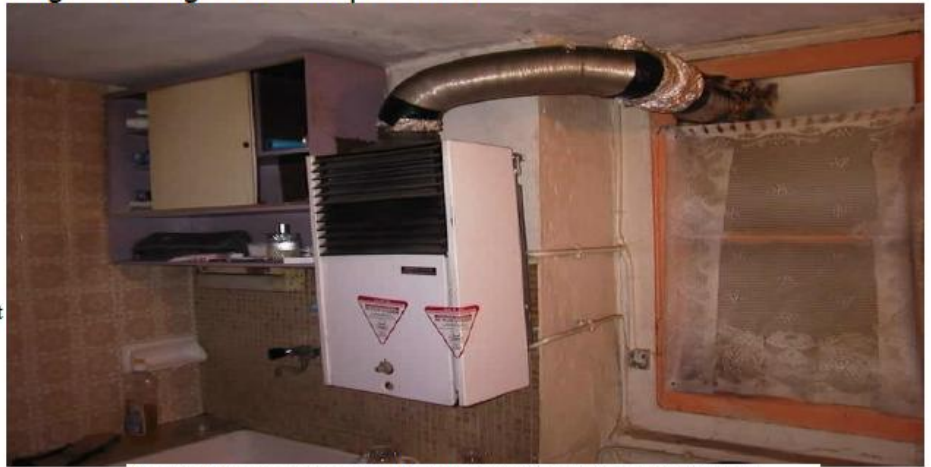
La chaudière au gaz responsable de l'intoxication était mal entretenue et installée dans une pièce mal ventilée. (photo P.H.)
