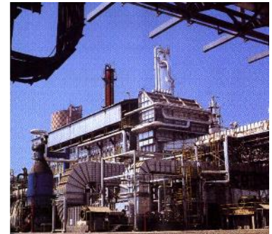
Vue d'un reformeur
